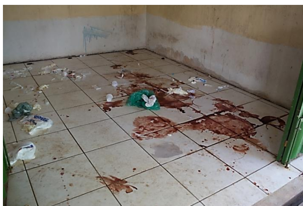
Figura 6 – Piso da Sala de Armazenamento de Resíduos com Vazamento dos Sacos. Fonte: Autores, 2015.
